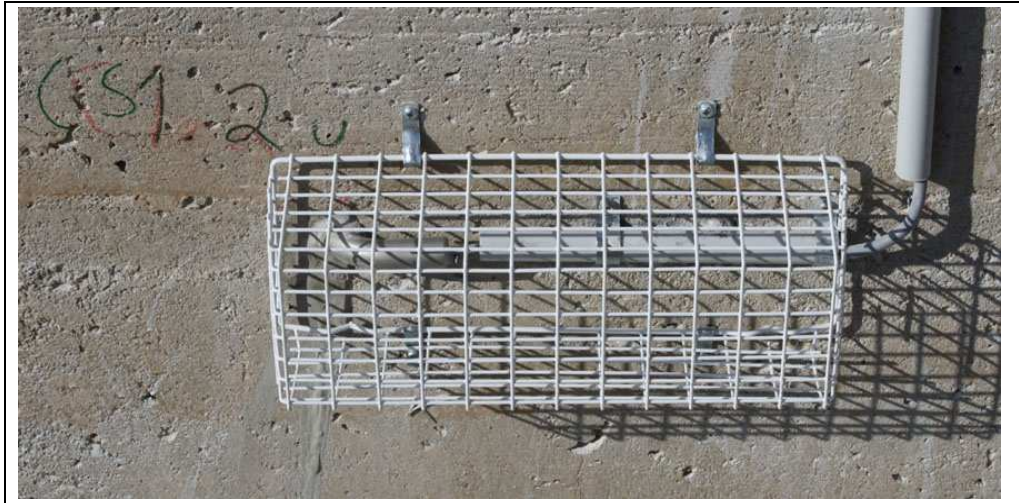
Abb. 3.17 Schutz des Temperatur- und Widerstandssensors (CS1.2u) gegen Vandalismus.
