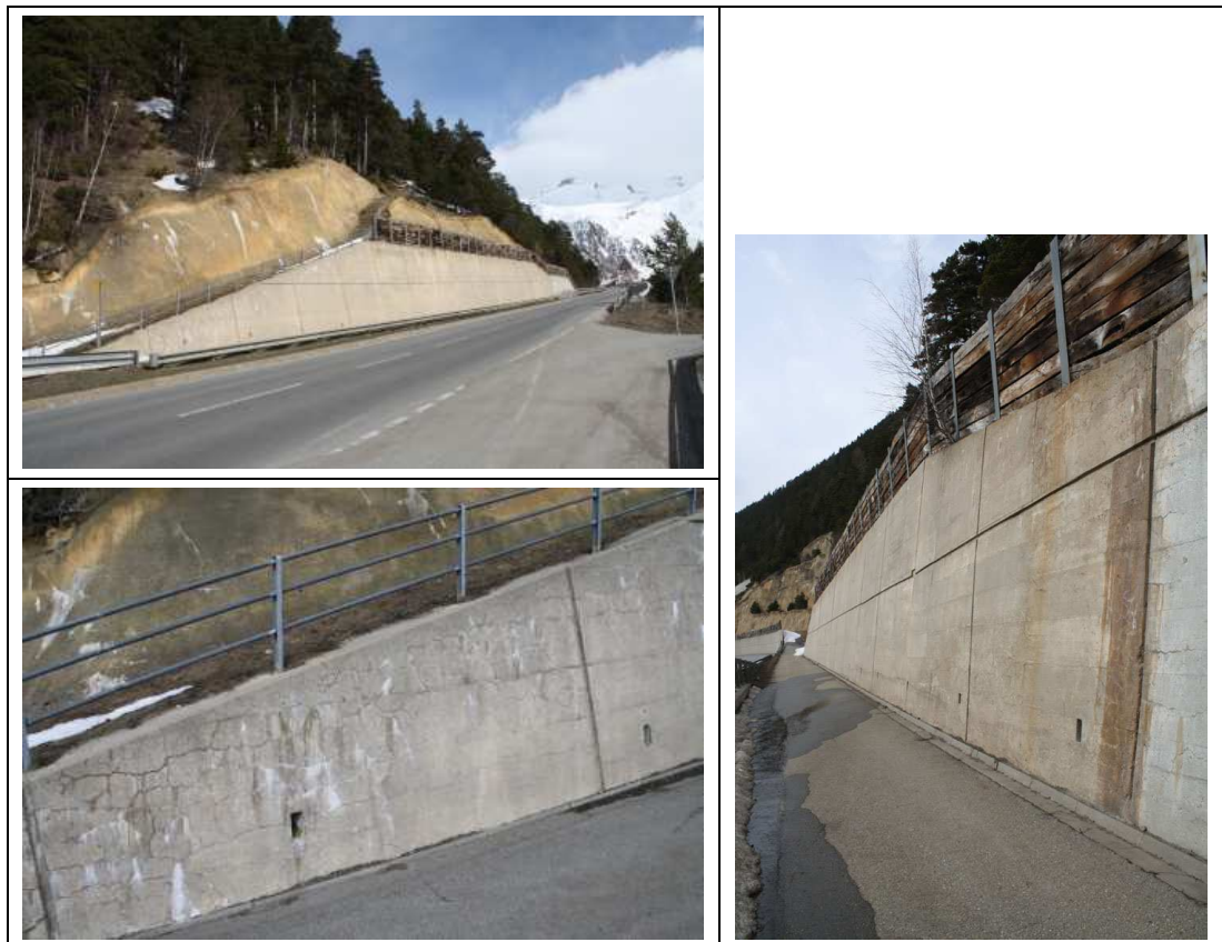
Abb. 3.1 Stützmauer S0751 (Eisten 1). Länge: ca. 147 m, Höhe: 6 bis 9 m ab OK Terrain. Erkennbar ist der Flurweg zwischen Stützmauer und Simplonstrasse (getrennt durch Leitplanken).
