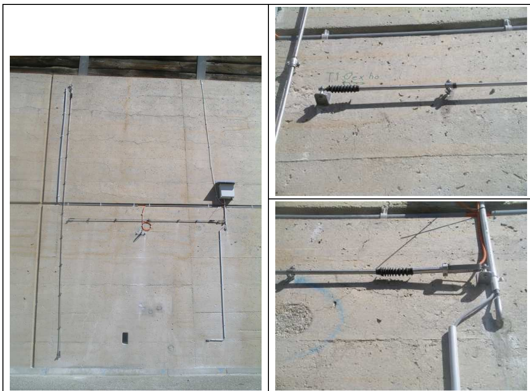
Abb. 2.8 Konventionelles Extensometer (Solexperts AG) am Beispiel der Installation am Objekt S7051 an der Simplonstrasse (siehe Kapitel 3.1).
