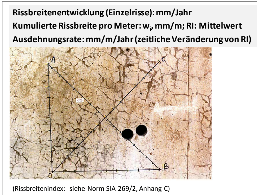
Abb. 2.2 Auswertung der Messung von Rissbreiten (Rissbreitenindex).
