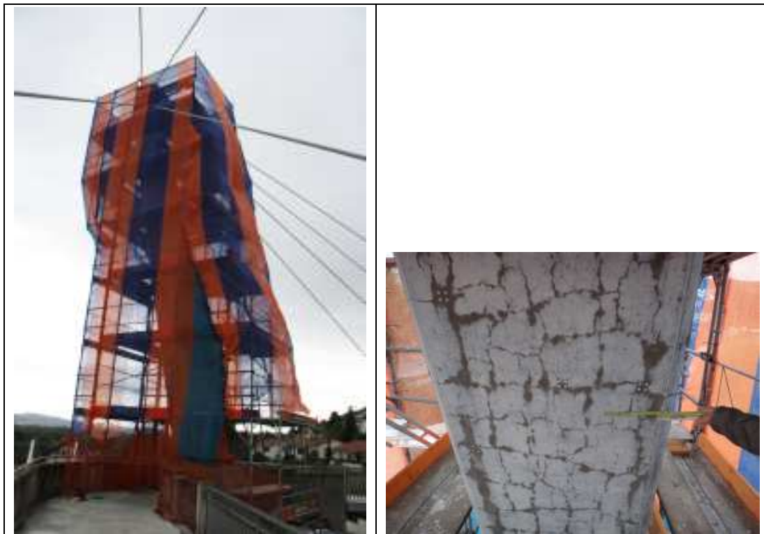
Abb. 3.21 Links: Eingerüsteter Pylon Rechts: Der Ausschnitt zeigt die gut erkennbaren (feuchten) Risse nach der Reinigung.
