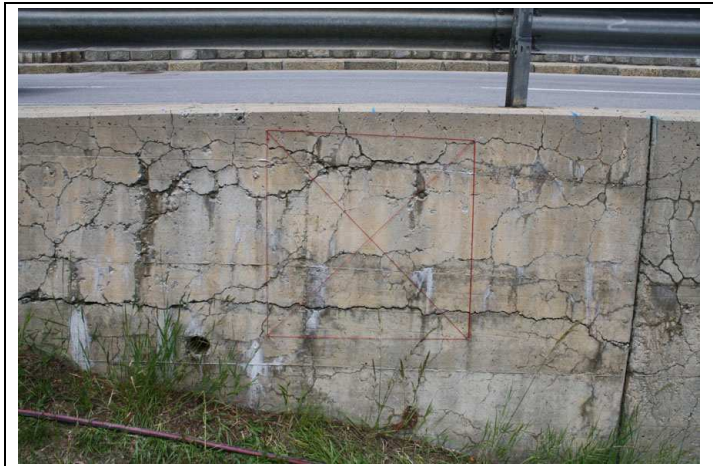
Abb. 3.10 Rissbreitenindex-Feld A: Bereich mit vielen Rissen an der Oberfläche.
