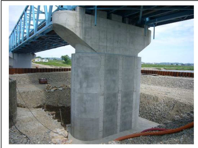
Abb. 2.25 Zustand nach der Instandsetzung mit Ersatz des Stützenkopfes [Daidai 2008].
