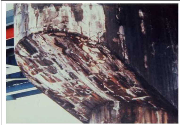
Abb. 2.23 Zustand des ca. 17 Jahre alten Pfeilers der Arisawa Brücke, District Toyama. Es ist ein typisches AAR-Rissnetz erkennbar. Die Beschichtung wurde 15 Jahre zuvor (Alter des Pfeiler ca. 2 Jahre) aufgebracht [Daidai 2008].
