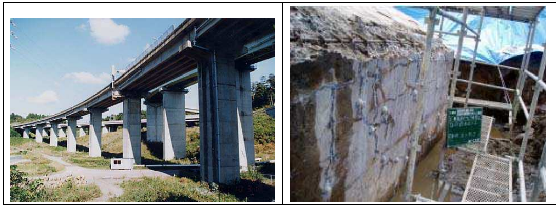
Abb. 2.17 Ansicht der Brücke (links) und frei gelegtes Betonfundament (rechts) [Okuyama 2008].
