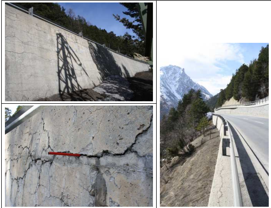
Abb. 3.2 Stützmauer S0701 (Ganter 8, Ze Brunnu). Länge: ca. 135 m, Höhe: 2 bis 4 m ab OK Terrain. Die Stützmauer liegt unterhalb der Simplonstrasse. Im Bild rechts ist ein deutlicher Riss in der Mauerkrone erkennbar.
